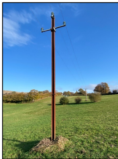
Figure 146 : Pylône métallique situé sur la parcelle A304, induisant des risques d'électrocution pour les rapaces notamment.
